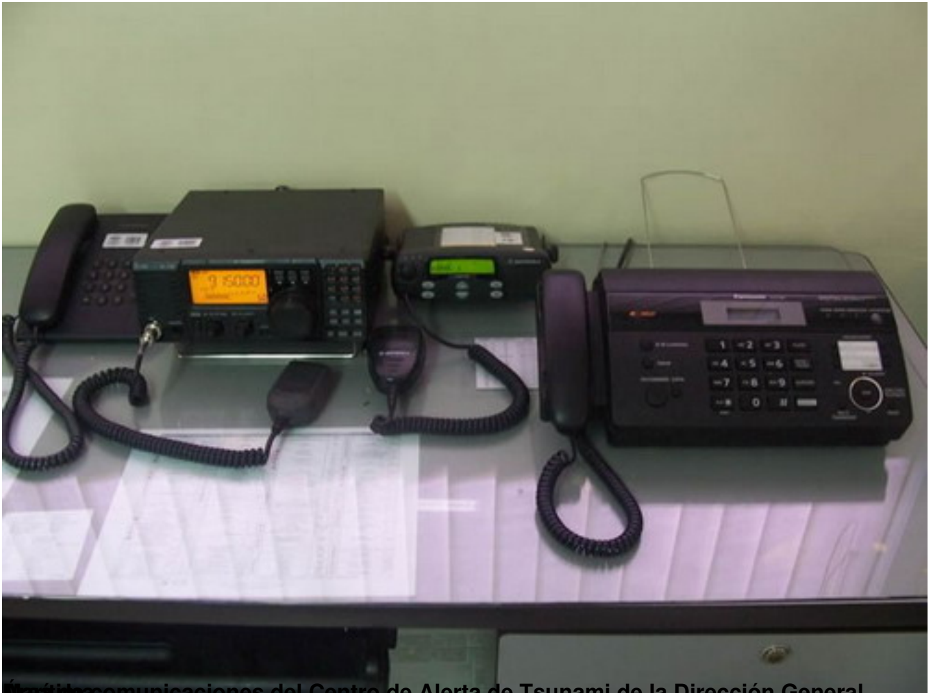
Instalación de Comunicaciones del Centro de Alerta de Tsunami de la Dirección General
